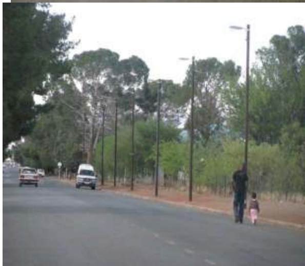
New street lights Kwezi (Hanover) street (De Aar)
